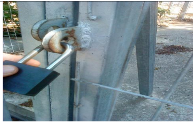
4. חלק מגדר דלת הכניסה בולט ומהווה מפגע בטיחותי
